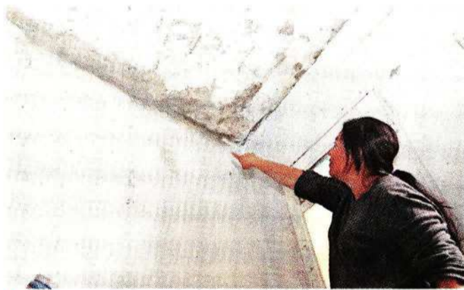
Elvia Mendoza, de Santiago Teyahualco, muestra los daños en su vivienda y reprocha que la obra colinde con su hogar.
