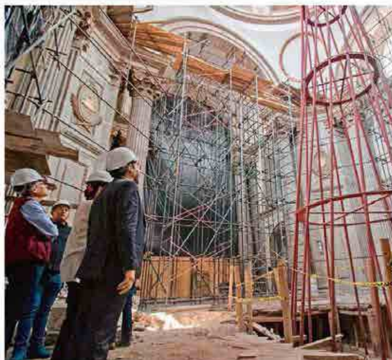
OBRAS. El mandatario local inspeccionó los trabajos de apuntalamiento en el Santuario de Nuestra Señora de los Ángeles, ubicado en la colonia Guerrero.
