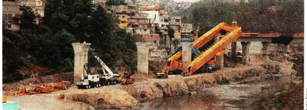
INICIA EL RETIRO. En la Presa Tacubaya, la armadora de dovelas que colapsó en abril comenzó a ser desarmada para su remoción.
