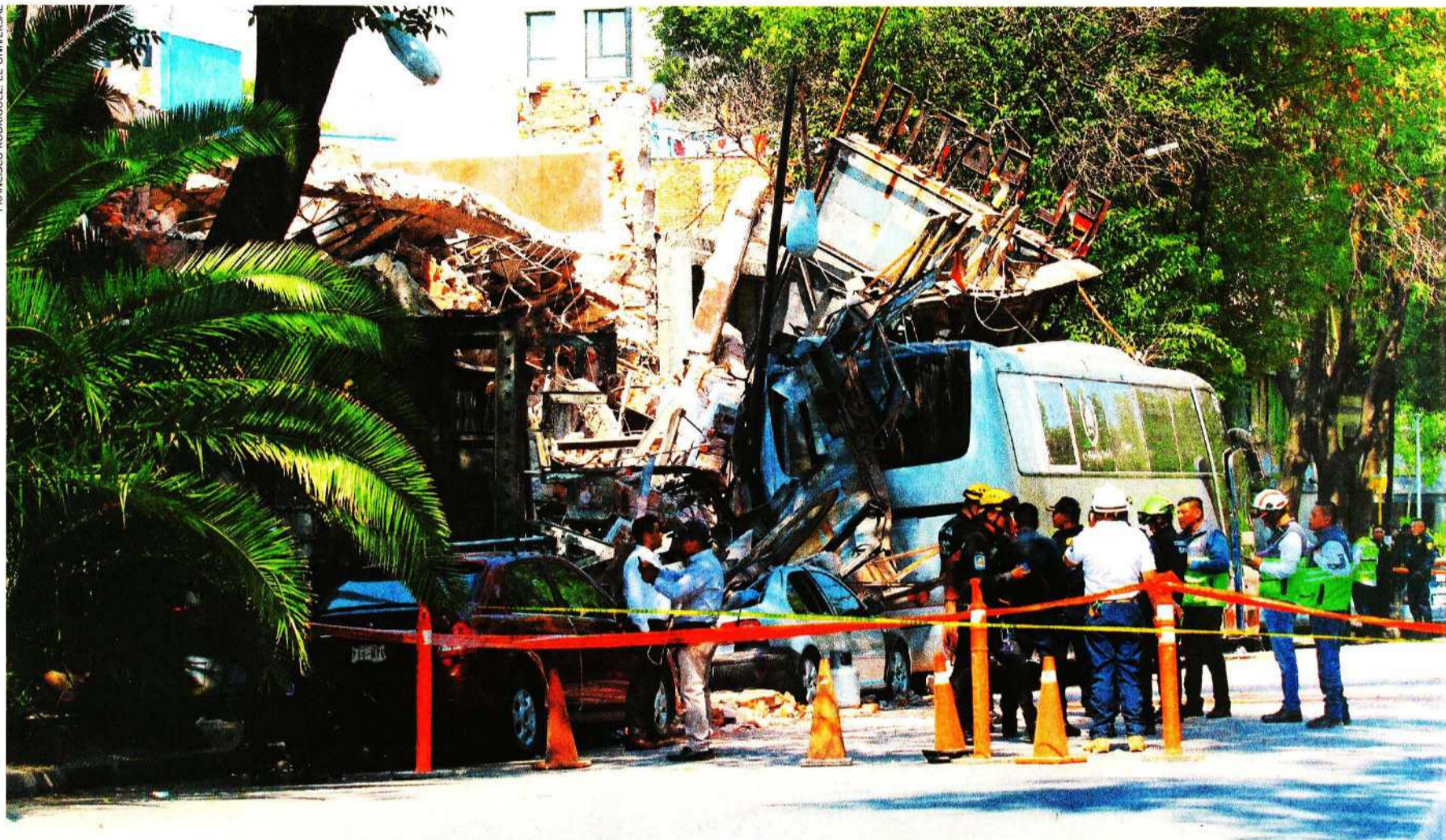
Dos coches y una camioneta de turismo quedaron debajo de los escombros de la fachada del excentro nocturno El Patio, ubicado en la calle Atenas, de la colonia Juárez.
