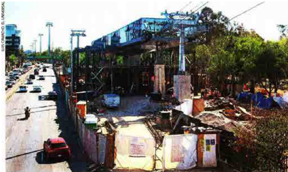
La construcción de la Línea 3 del Cablebús comenzó en septiembre de 2022, y de acuerdo con la empresa encargada, estaría lista en diciembre de 2023; luego se aplazó la fecha para junio de este año.
