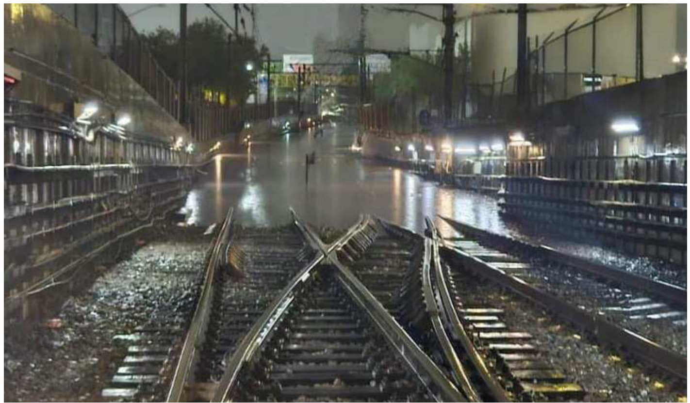
Personal de Instalaciones Hidráulicas y Mecánicas del Metro trabajó para drenar el agua que ingresó del exterior.
