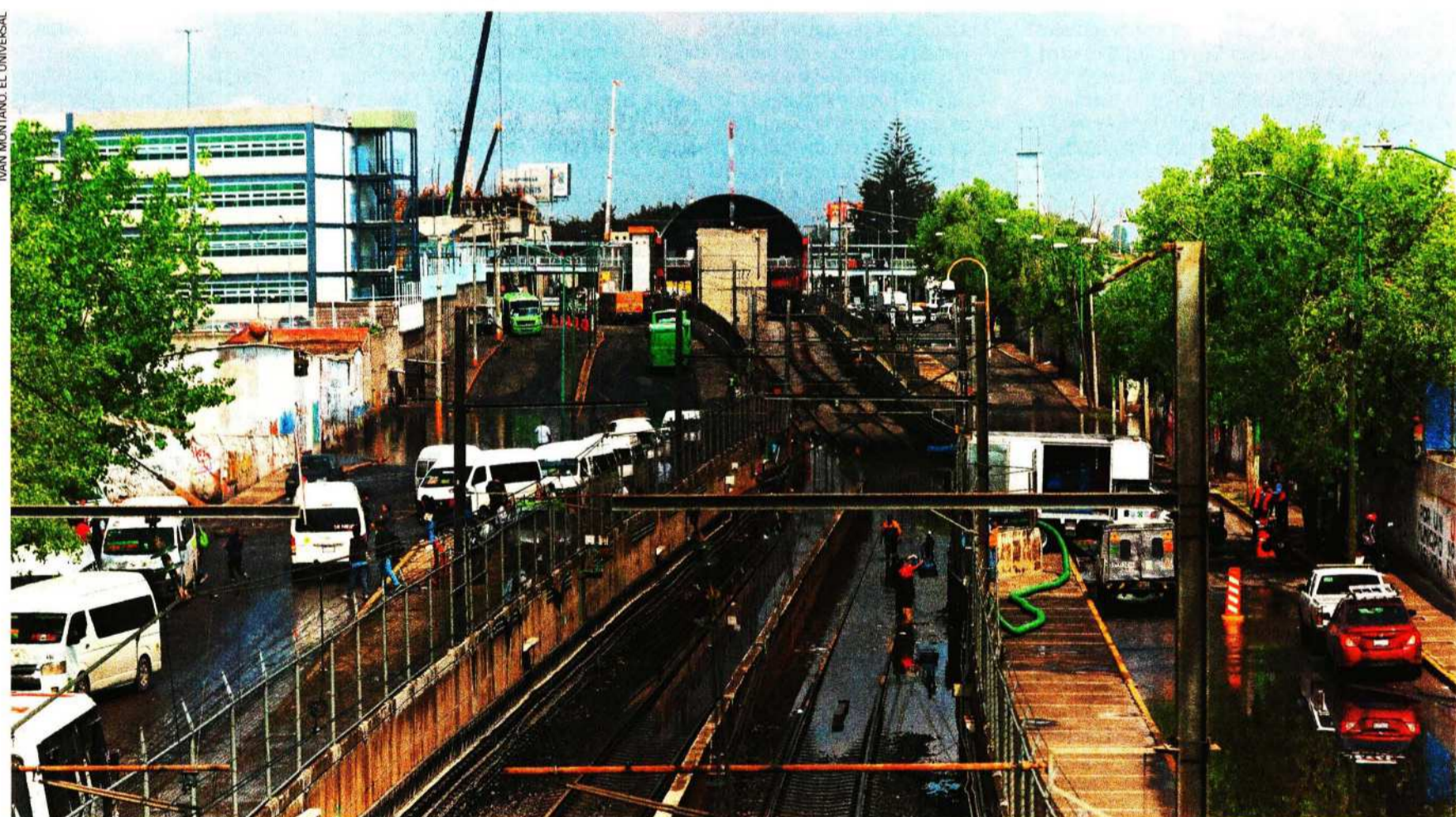
El agua de lluvia se estancó en el cajón de vías del tramo La Paz-Los Reyes, en la Línea A del Metro, por lo que personal del Sistema de Transporte Colectivo trabajó en el retiro del líquido y limpieza de la estructura para reanudar el servicio.
