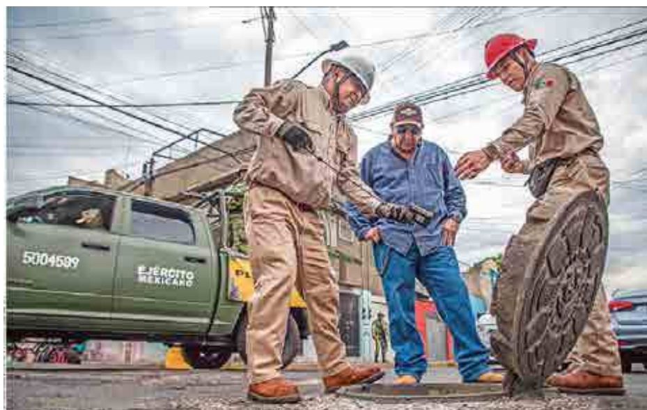
PRECAUCIÓN. Trabajadores de Pemex y Protección Civil de la capital realizan un constante monitoreo en la colonia Cuchilla del Tesoro sobre el nivel de explosividad en el drenaje.
