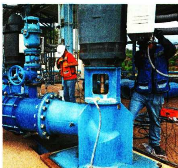
La planta potabilizadora Madín II inició operaciones el 8 de julio, informó la Conagua.
