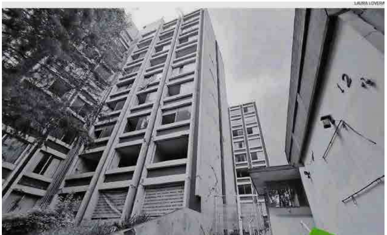
La fachada de Aguascalientes 12 no ha cambiado desde el sismo de 2017, aún luce agrietada
