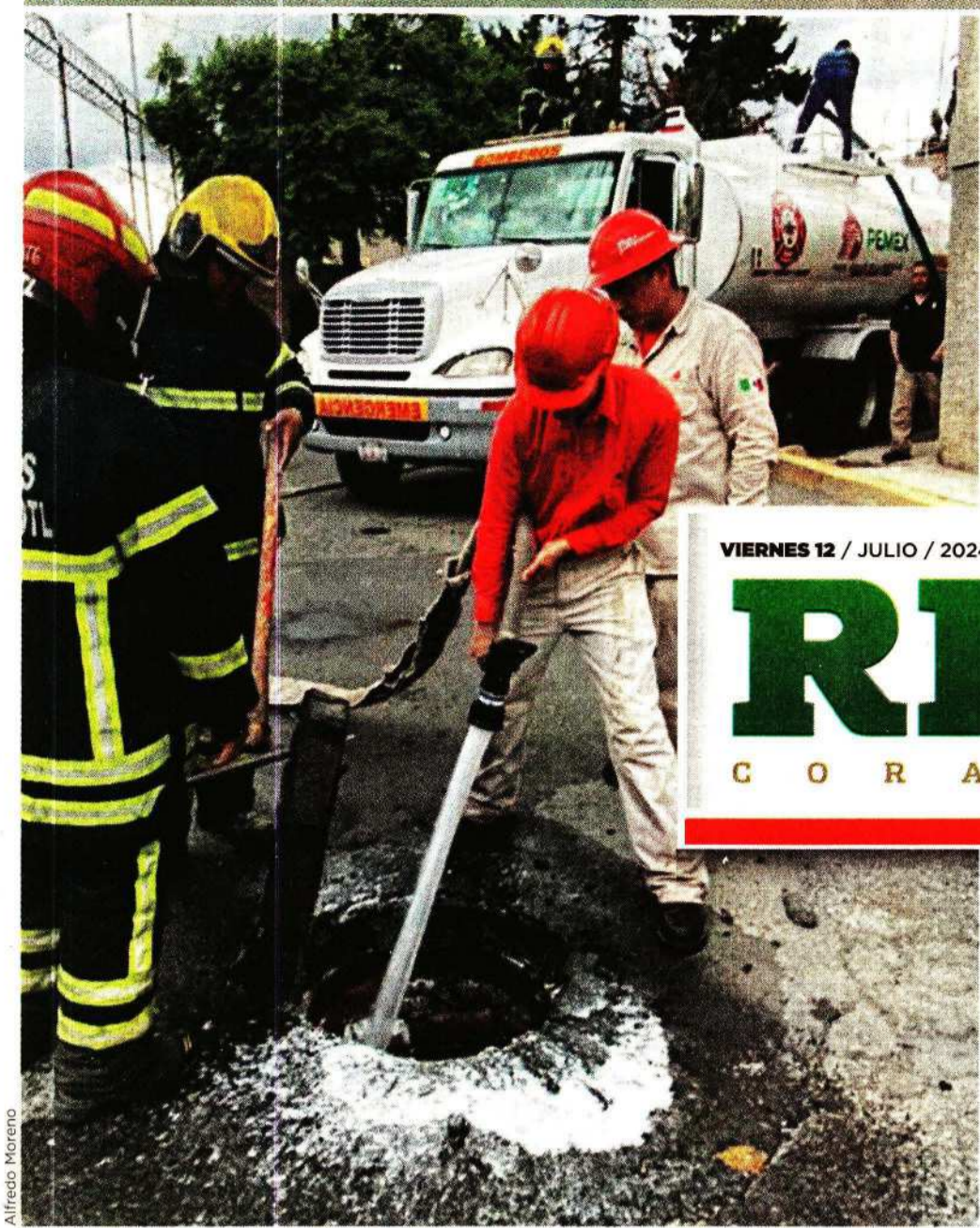
Personal de Pemex y de Bomberos continuó ayer con las labores de limpieza en el drenaje de la Colonia Ciudad Lago.
