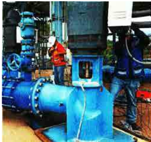
La planta potabilizadora Madín II inició operaciones el 8 de julio, informó la Conagua.
