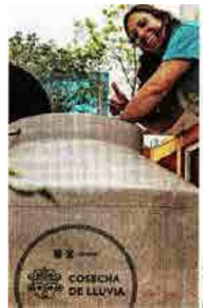
■ Los colectores se instalan tanto en casas, como en centros escolares.
