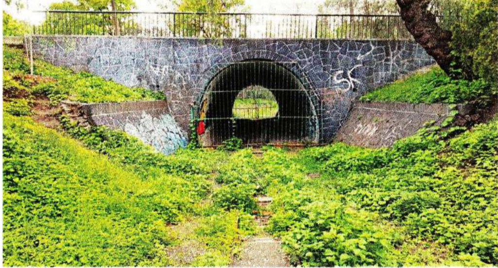
Sin uso, los túneles en la ruta se enrejaron para evitar el mal uso de esta infraestructura.
