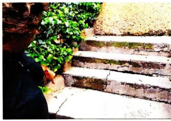
Los estruendos registrados desde el 18 de julio han causado grietas en algunas viviendas.
