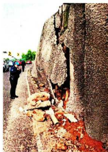
En Periférico se desprendió parte del muro de contención.
