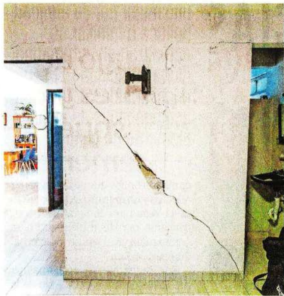
La vivienda de Paulina presenta daños en los muros. El gobierno local alista un proyecto de restauración.
