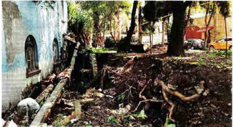
■ Dentro de la vivienda sigue derrumbada la barda que fue arrastrada por la corriente.
