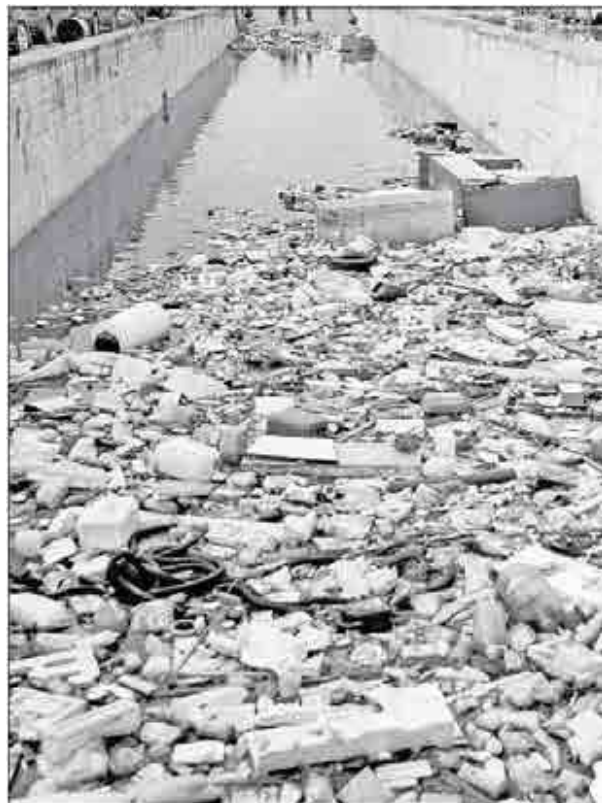
Escombros flotan sobre el agua en un túnel inundado, luego de las mortales inundaciones en España. Foto Afp
