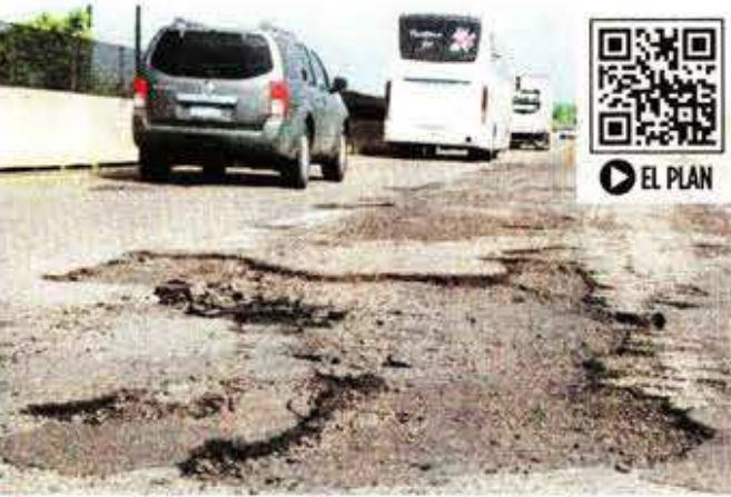
Las obras del Tren Maya dejaron casi mil kilómetros de carreteras dañadas, según datos de la SICT.
