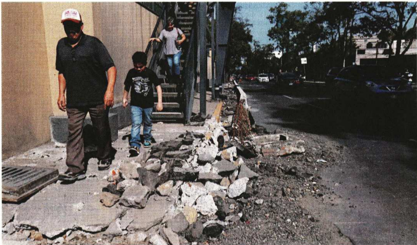
UN PELIGRO. Peatones deben pasar entre material de construcción y escombro para usar la banqueta en Constituyentes.
