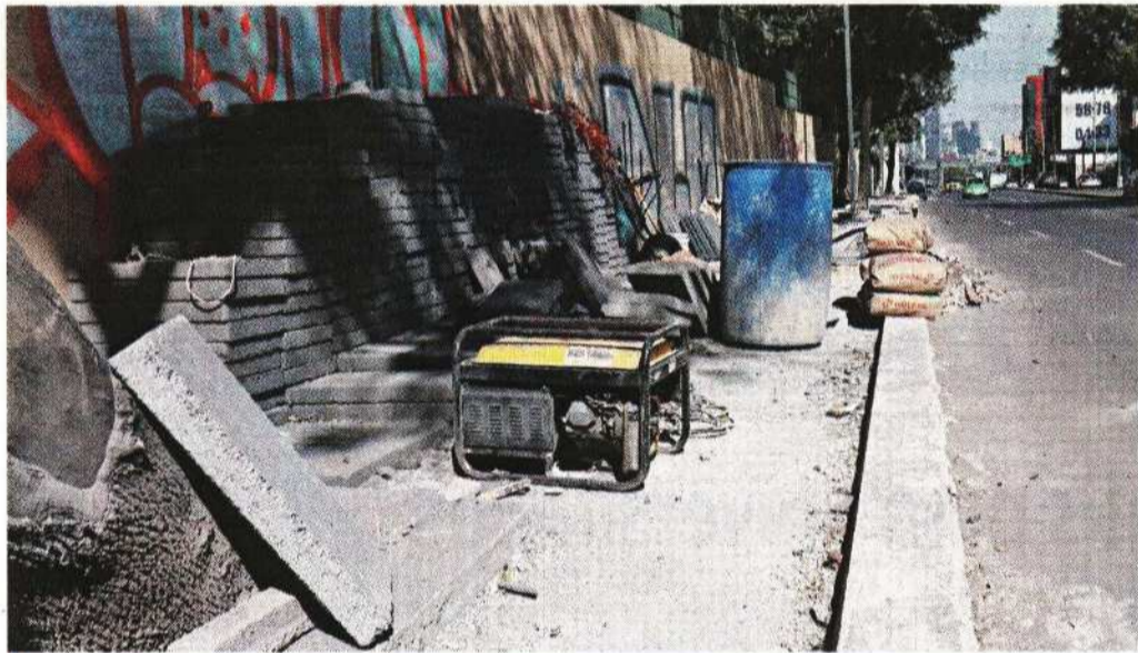
Algunas de las aceras están completamente bloqueadas por maquinaria y material.
