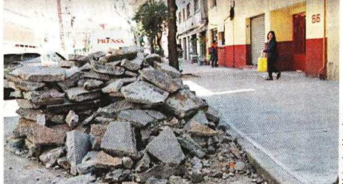
ENTRE CONCRETO. Vecinos deben maniobrar para evadir el montón de escombro que bloquea aceras y calles.
