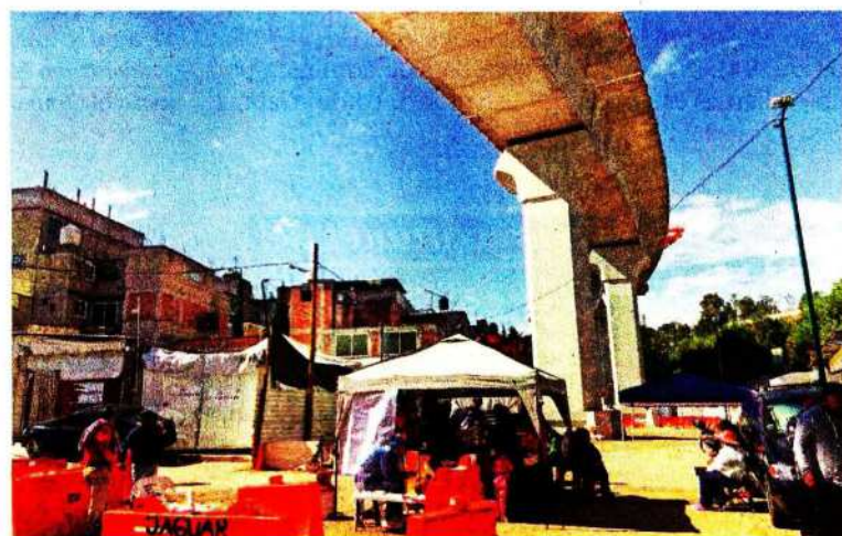
Vecinos de la colonia El Capulín llevan varios días de protesta en las obras del Tren Interurbano, porque, dijeron, las autoridades los ignoran.
