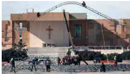
TRABAJADORES comienzan la instalación de un albergue temporal para deportados de EU, en Ciudad Juárez, ayer.
