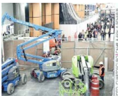
Están Inconclusas varias obras para el torneo
