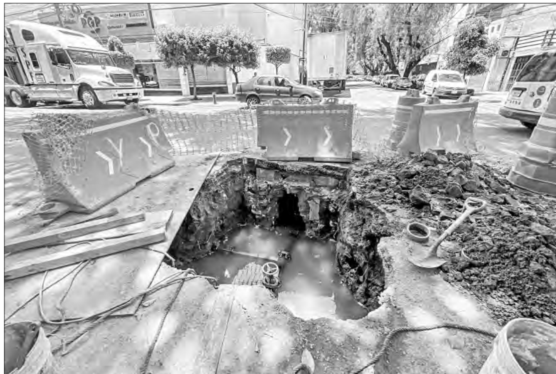
▲ A consecuencia de una fuga de agua se formó una enorme oquedad que complica el tránsito vehicular y pone en riesgo la integridad de peatones
