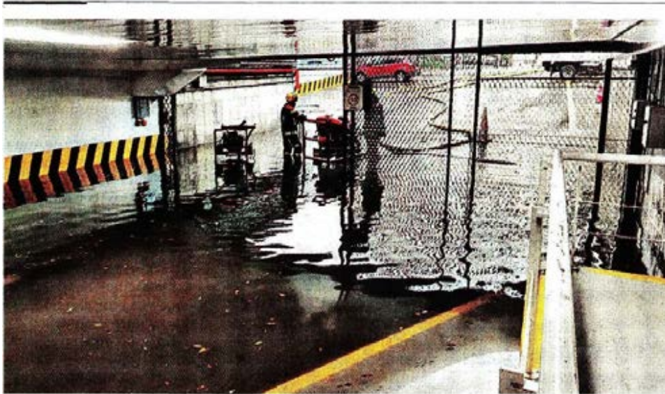
El estacionamiento de la Cámara de Diputados inundado. ESPECIAL
