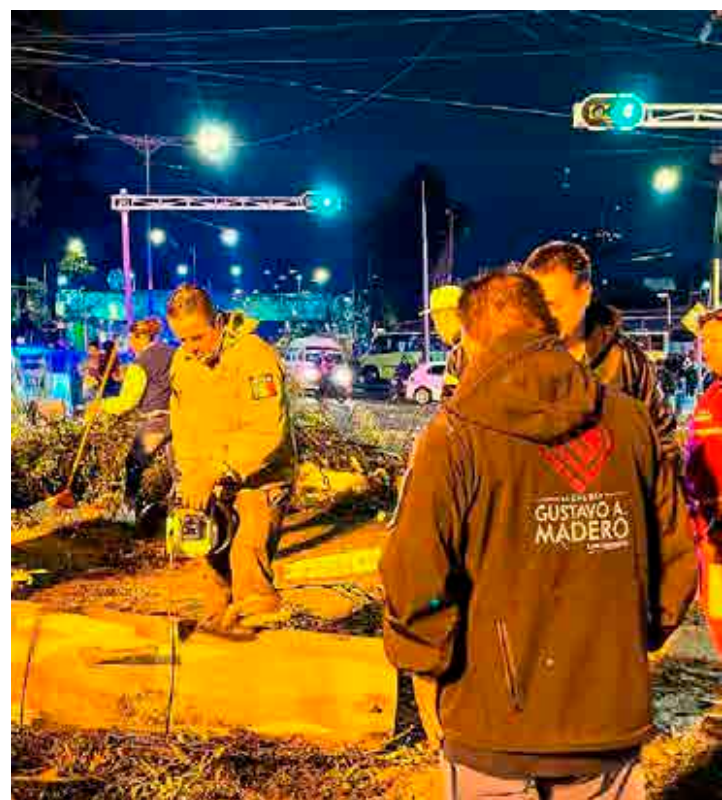
La precipitación afectó principalmente cinco colonias de la alcaldía; autoridades desplegaron un operativo con más de 400 trabajadores para atender las afectaciones.
