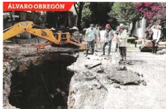
■ Hace dos semanas se abrió una oquedad en Calle Gutty Cárdenas, esquina con Ricardo Castro, en Guadalupe Inn.
