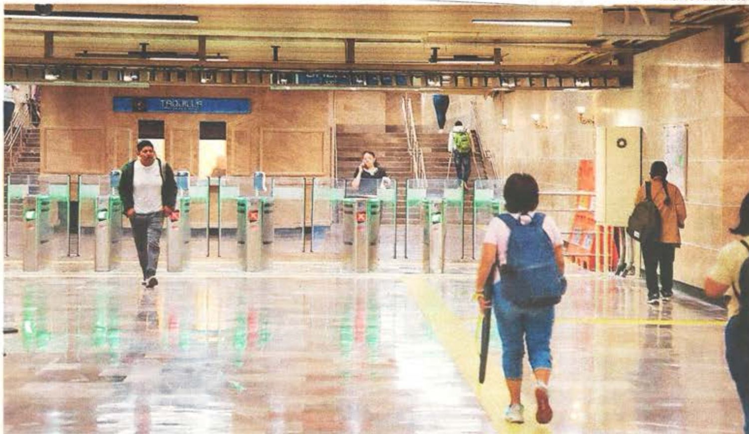
Puertas automáticas instaladas en la estación Hidalgo
