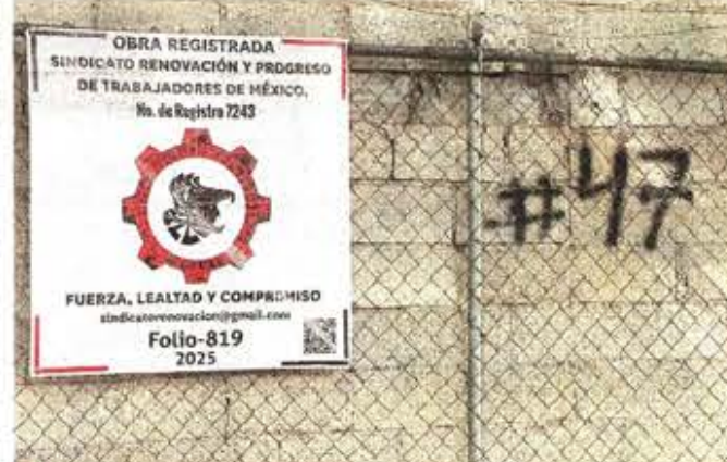
Aunque se exhiben lonas que demuestran que se realizan trabajos, no presenta permisos ni manifestación.
