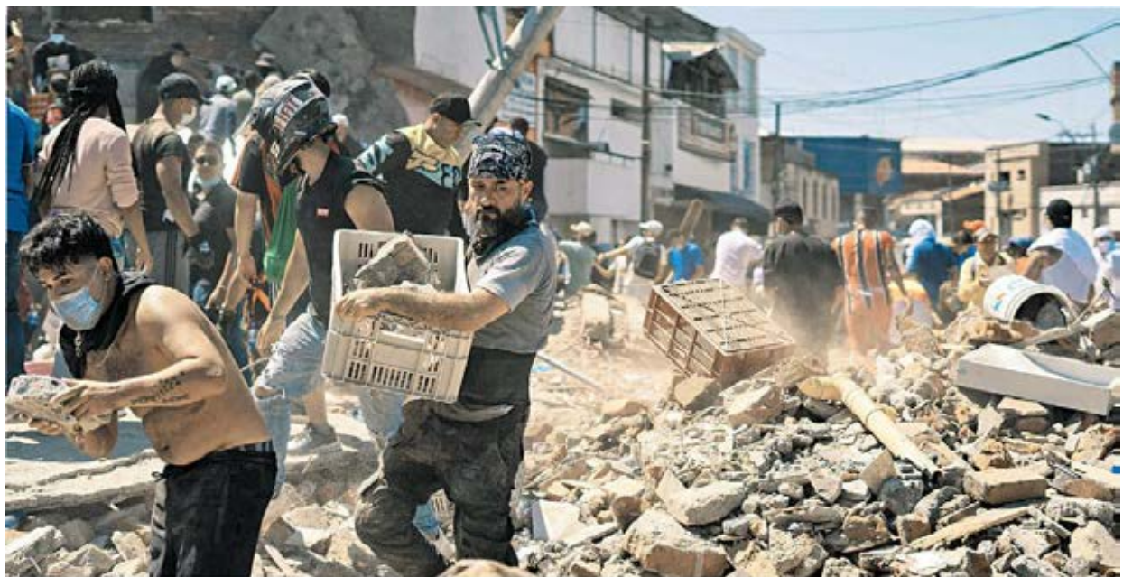
Ciudadanos retiran escombros de un edificio colapsado en Cali. REUTERS
