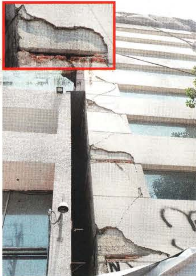
El inmueble, situado sobre Avenida Cuauhtémoc, quedó abandonado tras sufrir daños en el sismo de 2017.
