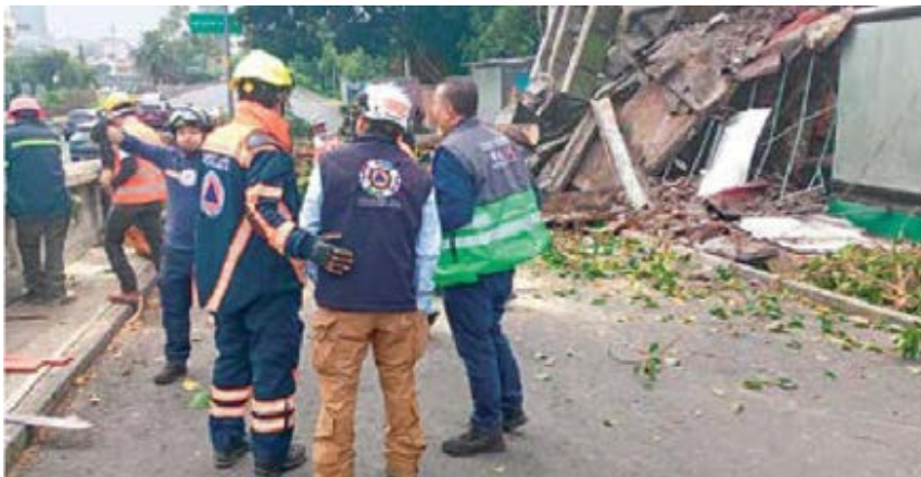
CONSECUENCIAS. La obra de demolición de cinco edificios quedó suspendida luego del desplome de uno de los inmuebles, lo que dejó a una persona lesionada.
