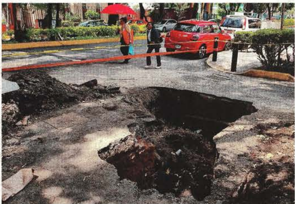
La oquedad, en la que cayó un camión vactor, permanece abierta y provocó el cierre de la vía.
