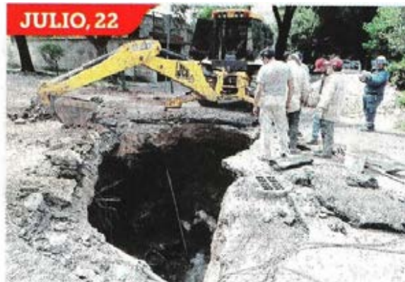
■ Un socavón de tres metros de profundidad se abrió en Calle Guty Cárdenas, en la Colonia Guadalupe Inn, en AO.
