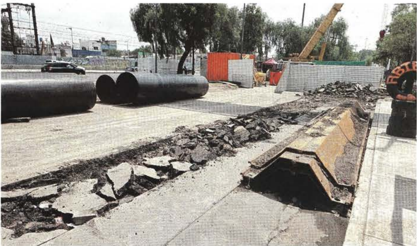
RIESGOS. Vecinos advierten que el uso de maquinaria podría reabrir grietas que se registraron años atrás en la zona.
