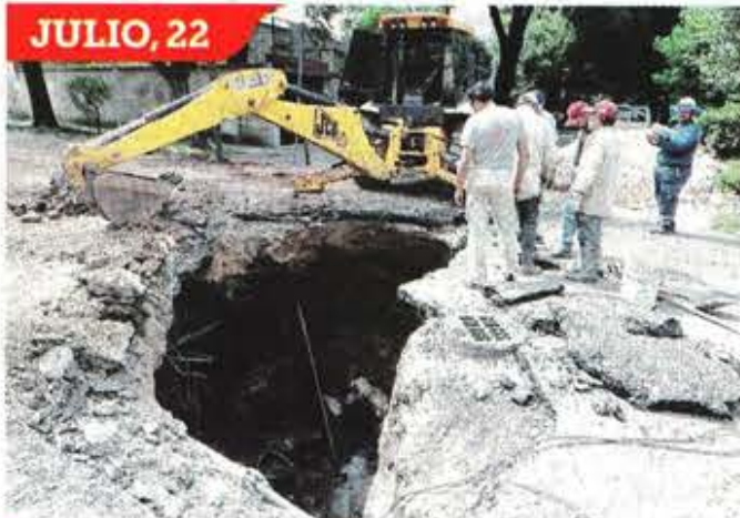
■ Un socavón de tres metros de profundidad se abrió en Calle Gut y Cárdenas, en la Colonia Guadalupe Inn, en ÁO.
