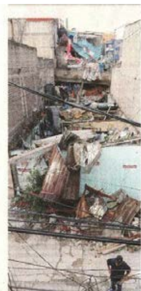
Un inmueble aledaño al sitio donde ocurrió la explosión registró daños estructurales.
