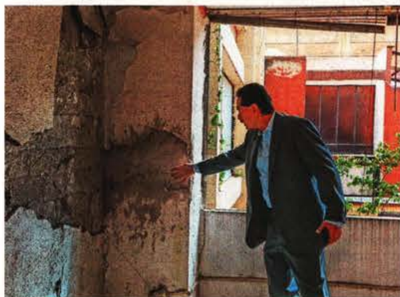
El edificio de Aguascalientes 12 tiene daño estructural y hay riesgo de colapso. Vecinos piden su reconstrucción, otros están por la rehabilitación.
