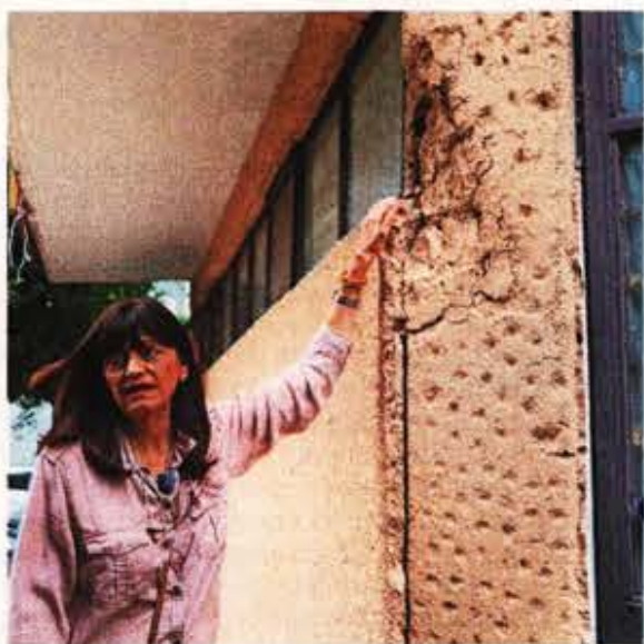
Habitantes de Patricio Sanz 529, colonia Del Valle, dicen que cada día hay mayor deterioro en el edificio.
