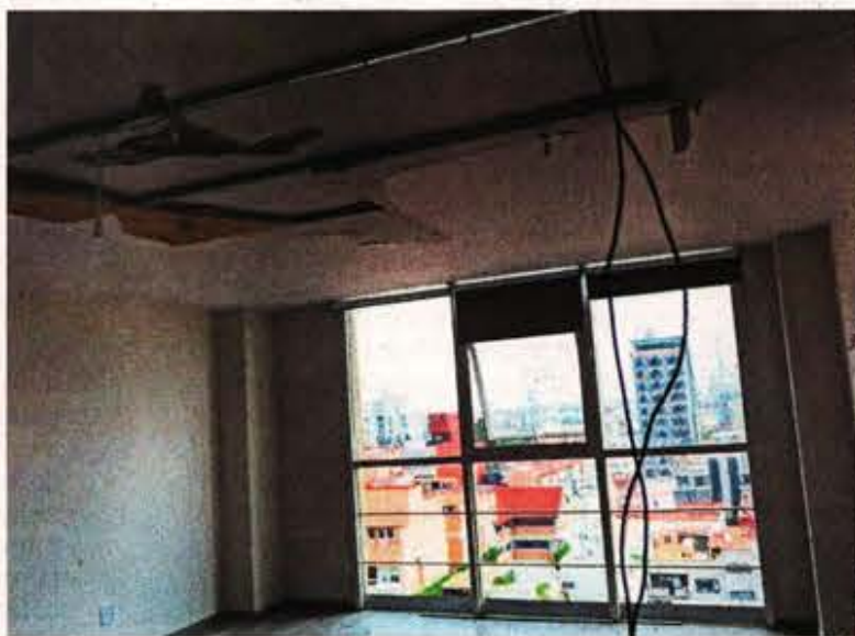
En Patricio Sanz 529 adquirieron departamentos, pero la inmobiliaria no les informó que el edificio había sido dañado en el sismo de 2017.
