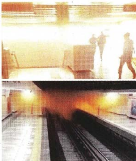
■ El cortocircuito provocó un chispazo y una densa nube de humo cubrió el andén de la estación Gómez Farías.
