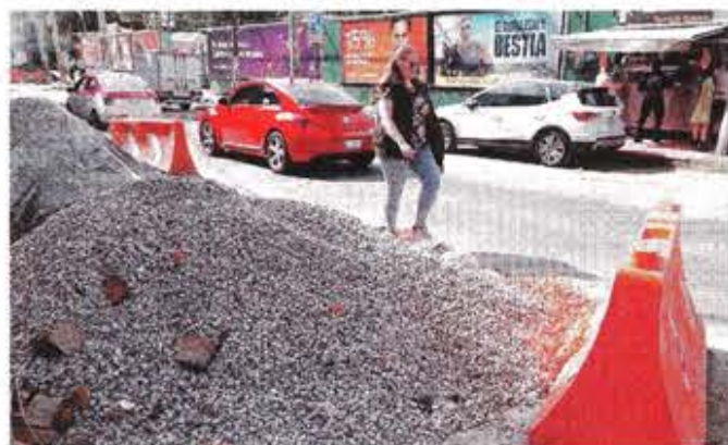
Material de construcción obstruye banquetas en Calle Puebla; peatones deben caminar sobre el arroyo vehicular.
