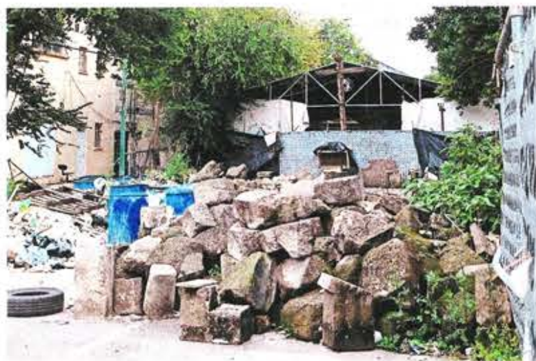
La rehabilitación de la parroquia no ha concluido debido a la complejidad técnica del inmueble, informó el INAH.
