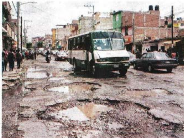
· Muchas avenidas siguen en mal estado y no fueron intervenidas
